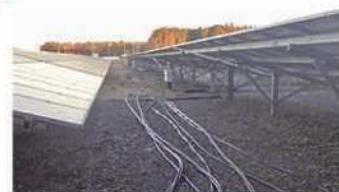
太陽光発電施設での被害状況
