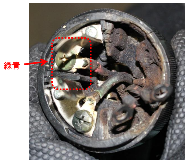
図 2-6 プラグ内部の緑青の状況
