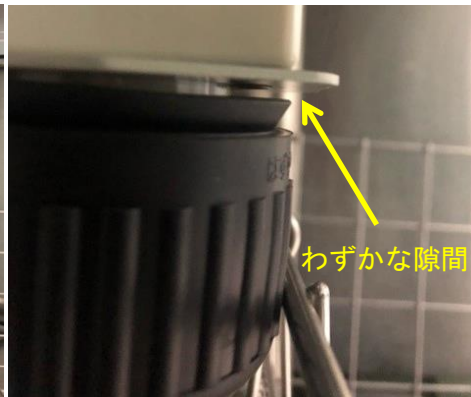
コンセントカバーを外してプラグとコンセントの状況確認
