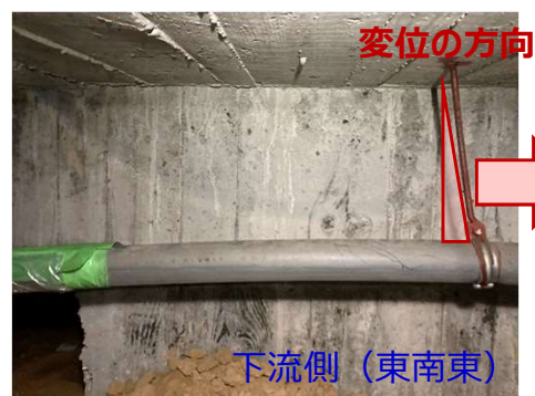
破断配管 A下流側吊り金具
