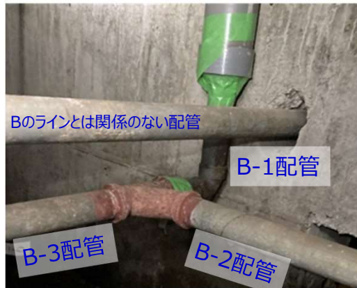
脱落配管B 脱落前状況 (現場写真)
