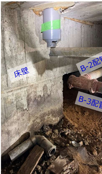
脱落配管B 脱落状況
