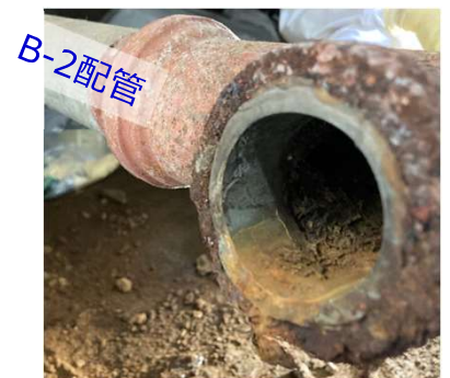
脱落配管B 鋳鉄チーズ破断部
