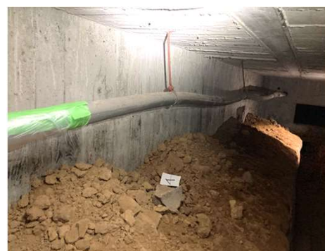
破断配管A全景
