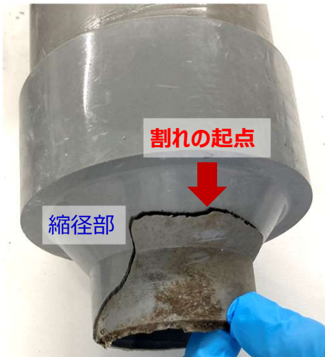
脱落配管B レデューサー破断状況
