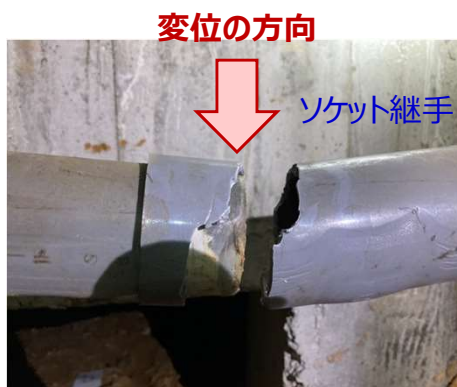
破断配管A 破断部
