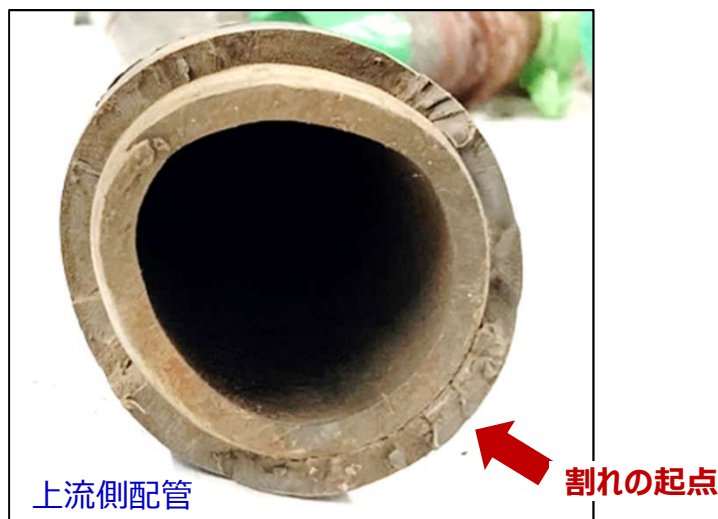
破断配管A 上流側ソケット破断面
