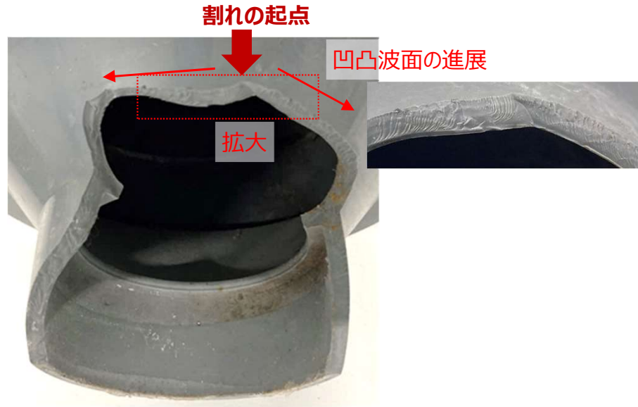
脱落配管B レデューサー破断面
