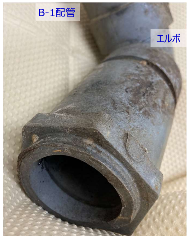
脱落配管B バルブソケット破断面
