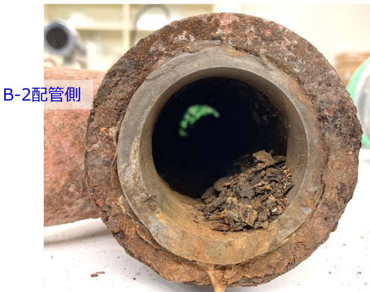
脱落配管B バルブソケット鋳鉄チーズ側破断面
