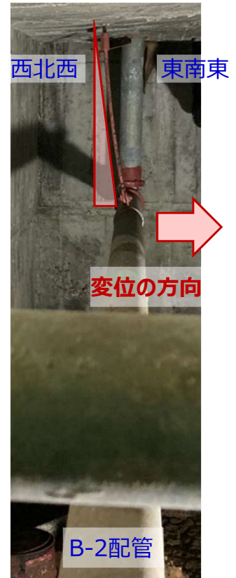
脱落配管B 上流側吊り金具部分
