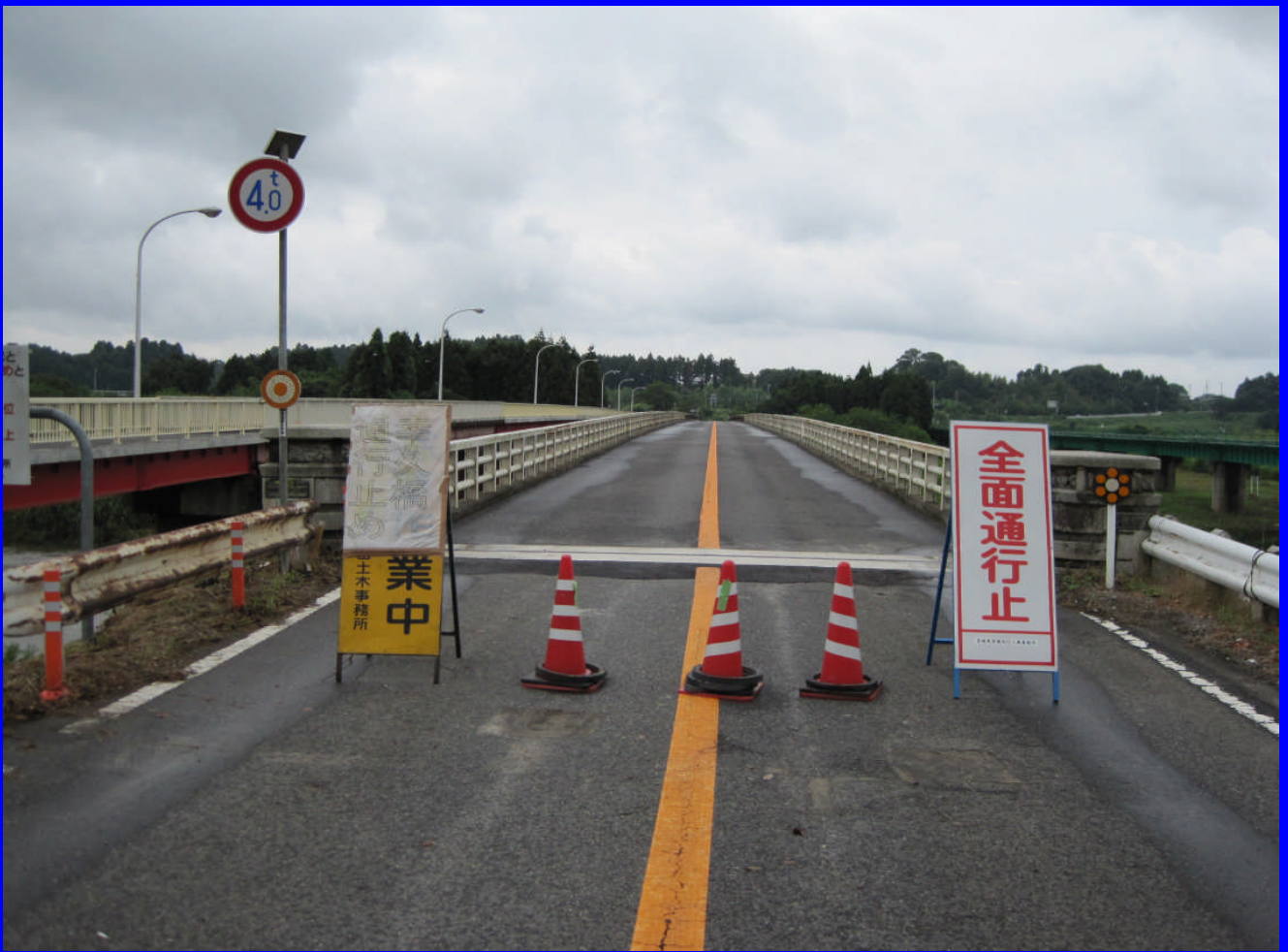
被災状況写真
