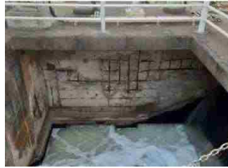
塩素混和池の鉄筋露出状況
