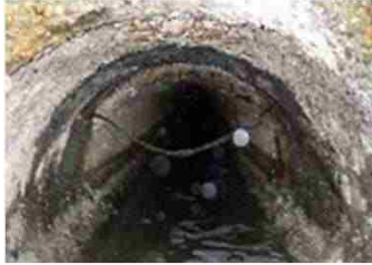
管渠の腐食状況
