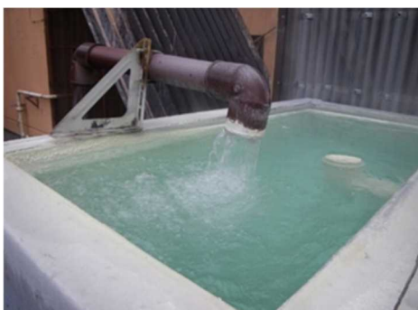
図 2 落下式ばっ気槽
