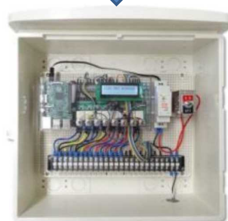
制御ノードの内部
