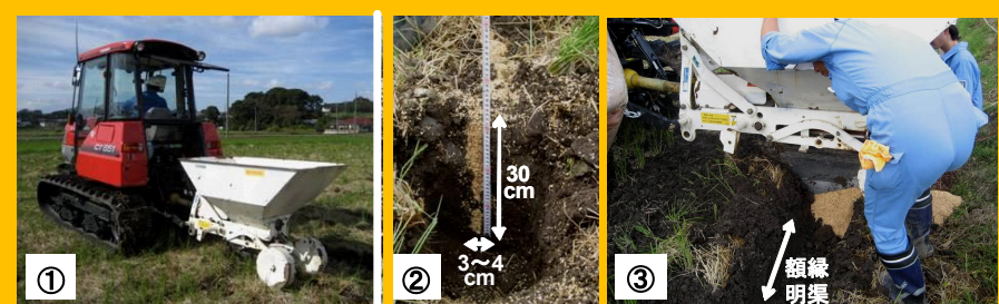
図3 明渠と結合させた粗穀充填補助暗渠の施工(①疎水材心土充填機を使用した施工作業、②施工後の土壌断面、③明渠と補助暗渠の結合部)
