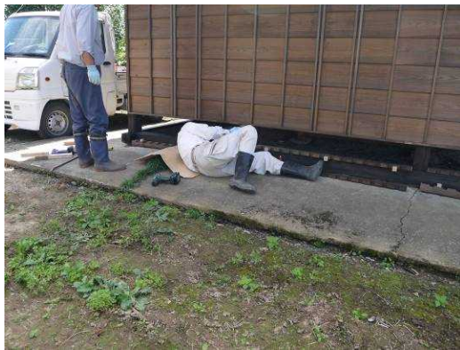
浸水した薬師堂縁の下の木質化作業
