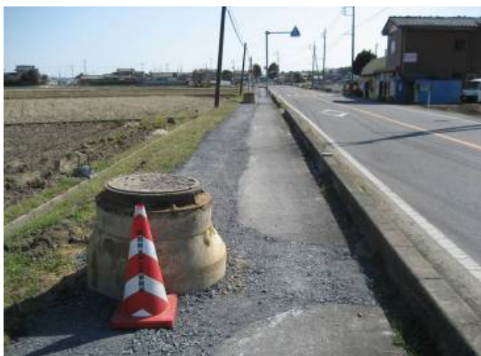
マンホールの浮上(水戸市上国井地区)
