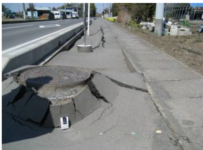
マンホールの浮上(那珂市鴻巣地区)
