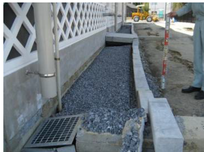
処理場周辺の沈下(那珂市鴻巣地区)
