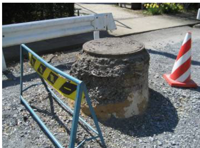
マンホールの浮上(水戸市飯富地区)
