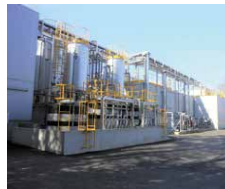
排水処理施設
