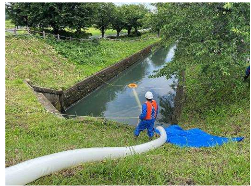
排水ポンプ車訓練
