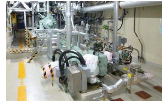
（参考：既設設備配置例）原子炉隔離時冷却系ポンプ・タービン
