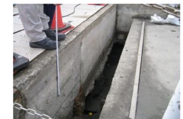
地盤沈下に伴う段差の発生（取水口エリア）
