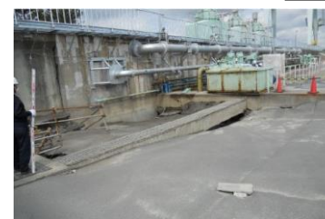
地盤の沈下状況（取水口エリア①）
