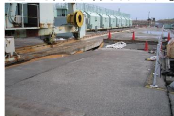
地盤の沈下状況（取水口エリア②）
