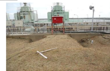
地盤の沈下状況（循環水配管埋設エリア）
