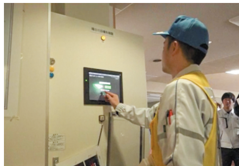
陽圧化装置を起動する様子
