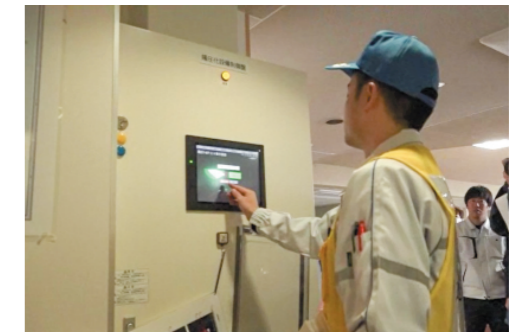
陽圧化装置を起動する様子
