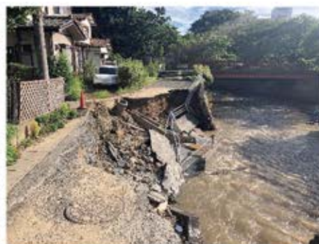
管渠の被災状況 (日立市：神峰町)
