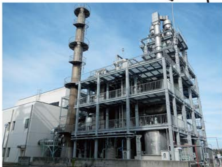
広域汚泥 1号焼却炉
