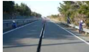
写真② 国道51号 大洗町成田町 ⇒段差発生により通行不能
