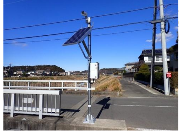
簡易型河川監視カメラの設置イメージ
