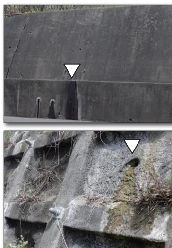
地下水の流出
