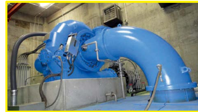
管理用発電所 内部
