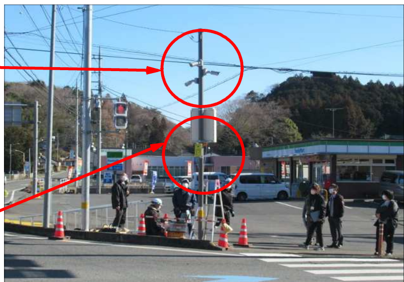
設置完成検査の様子
