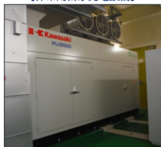
【非常用自家発電設備】
