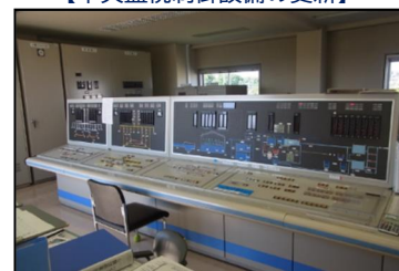
【中央監視制御設備の更新】
