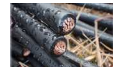
切断された金属ケーブル
