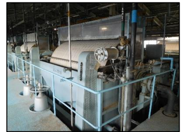
【排水処理施設の更新】
