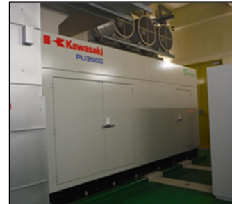
【非常用自家発電設備】
