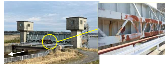
【写真 1】水門ゲートの腐食事例 (銚田排水機場)
