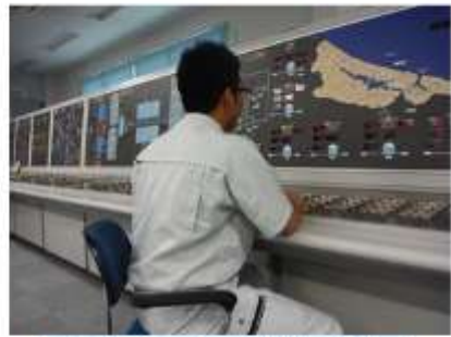
浄水場の運転監視業務
