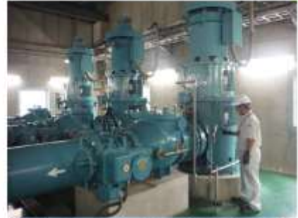
機械電気設備の点検業務
