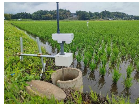
ICT自動給水栓の導入
