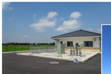
農業集落排水施設
