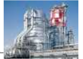
川崎製油所常圧蒸留装置
