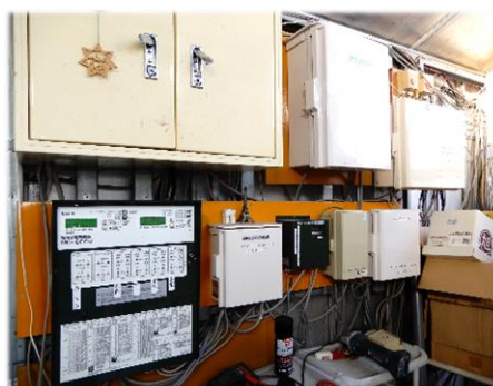
環境制御装置、環境モニタリング機器
