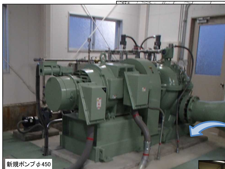
第9機場 ポンプ
