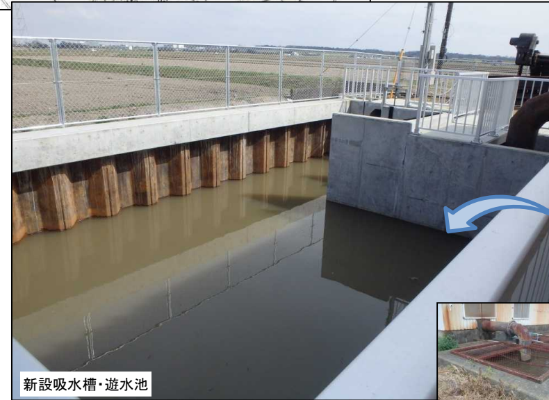
第9機場 吸水槽
