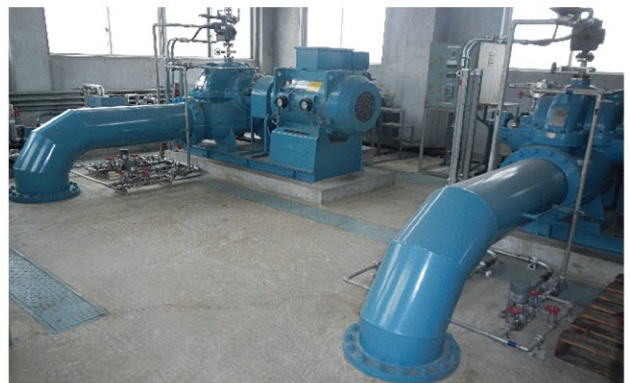
ポンプ設備(田川用排水機場地区:整備後)
