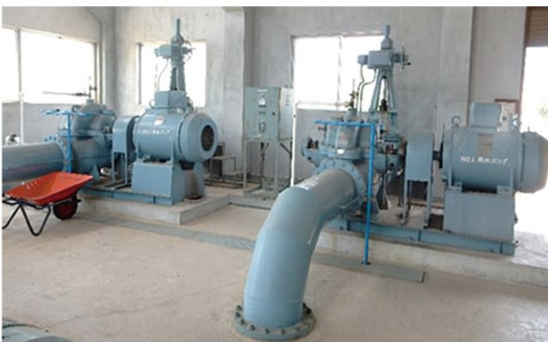
ポンプ設備(田川用排水機場地区:整備前)
