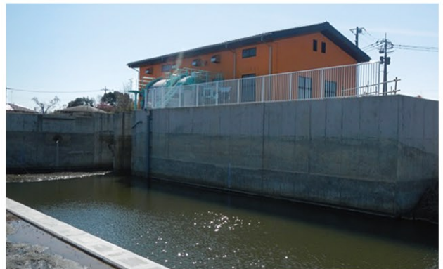
余郷入排水機場(余郷入地区)
