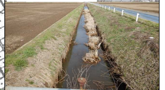
排水路(経年劣化)
