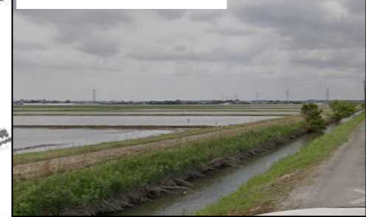
導水路(経年劣化)
