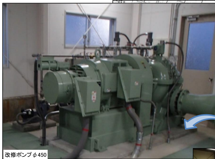
第9機場 ポンプ
