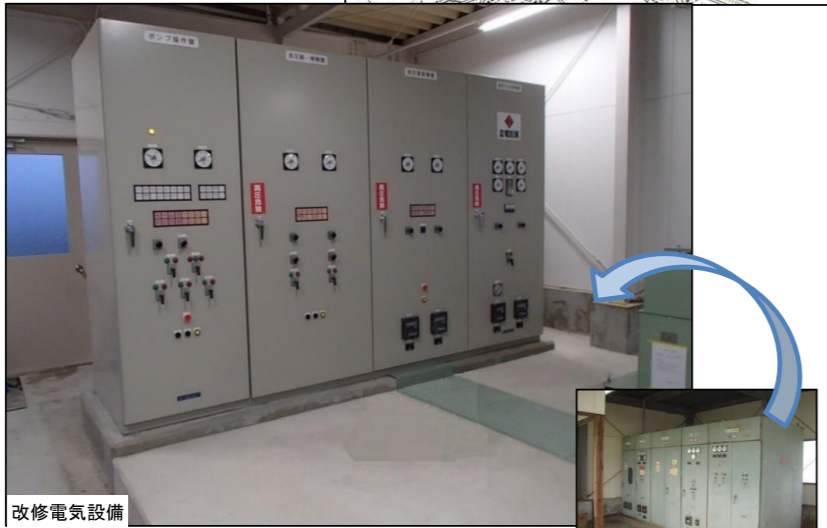
第9機場 電気設備
