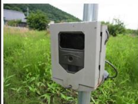
防犯カメラの設置
