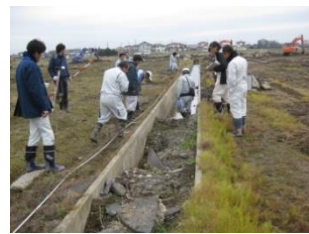
常総市内被災箇所の災害査定状況
