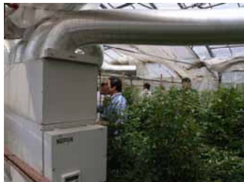
図 -2-11 室内機とダクト
