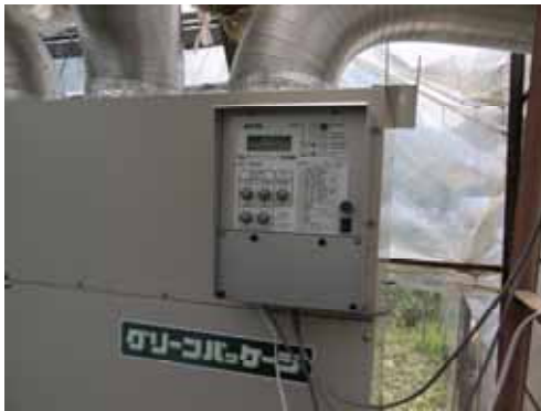
図 -2-10 室内機とハイブリッド制御盤
