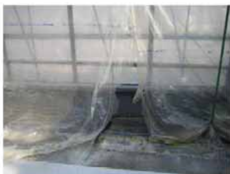
図 -2-2 二重被覆の隙間
