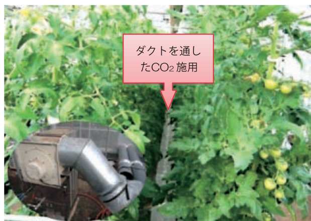
炭酸ガス発生装置とその設置例
