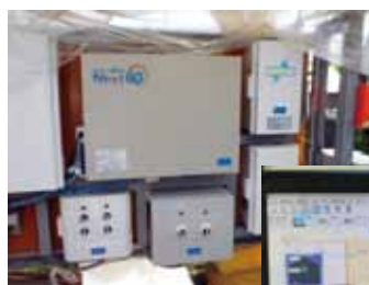
写真1 統合環境制御盤
