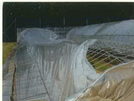
図3 風による倒壊、被覆ビニルの破損
