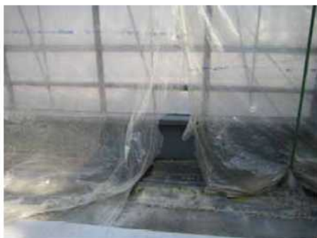
図II-2-2 2重被覆の隙間
