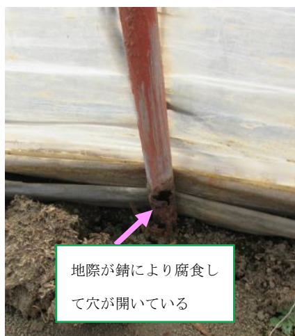
写真1 脚部の腐食状況
