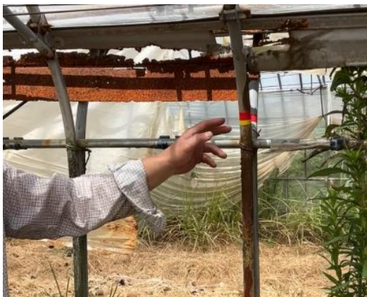
写真1 谷部の雨樋部分の腐食
