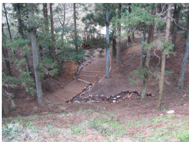
現場発生材を利用した歩道と水路
