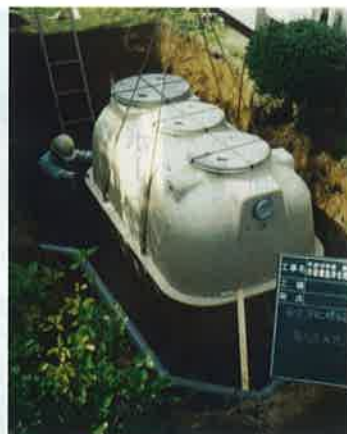
高度処理型浄化槽
