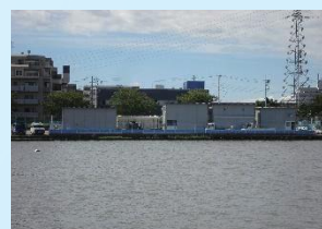
直接浄化施設(土浦港)
