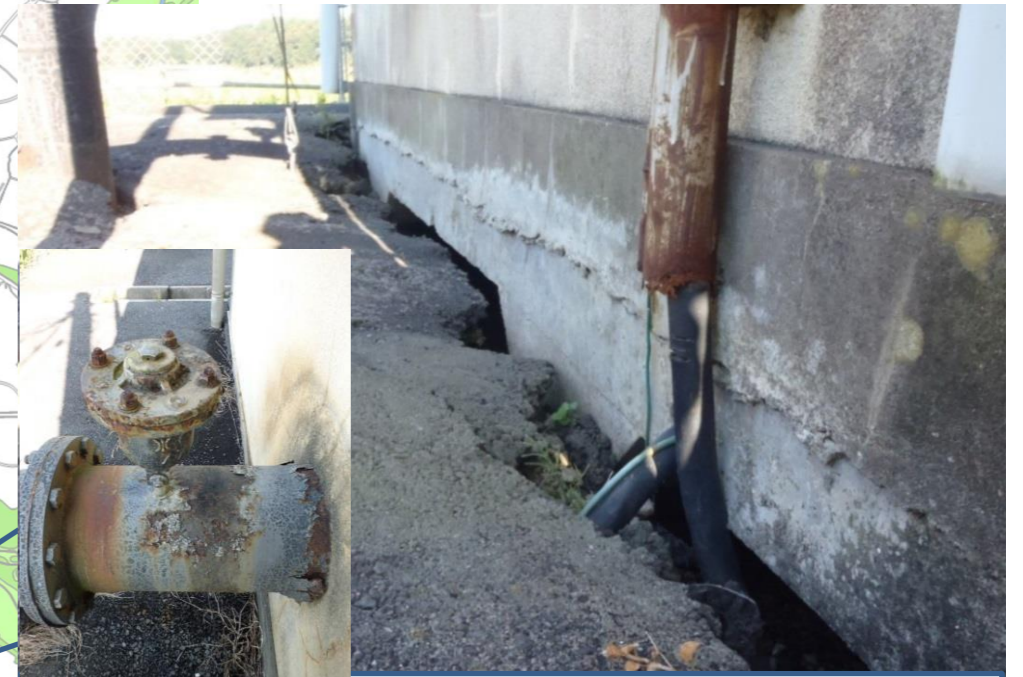
老朽化が著しい用水施設の改修
