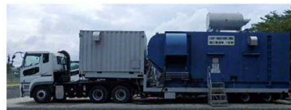
常設代替交流電源設備
