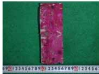
③中性化深さの点検状況 (フェノールフタレイン溶液による確認)
