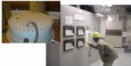
二重蓋間圧力監視(密封性確認)
